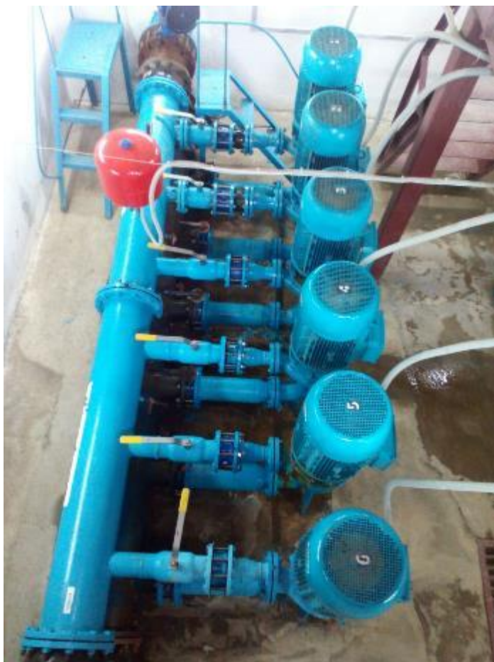
Рисунок 68 Насосное оборудование ВНС №4
